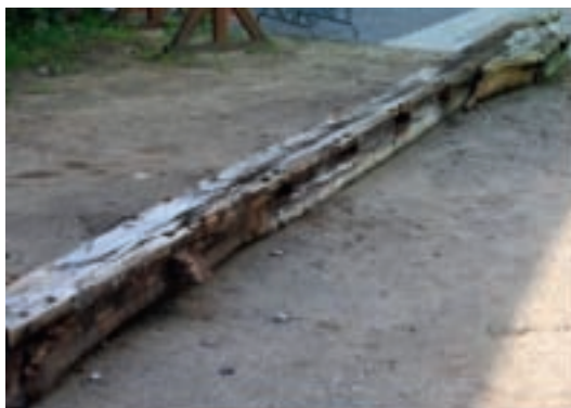
Zerbrochen, der Hausbalken über der Grootdöör des Bauernhauses.
