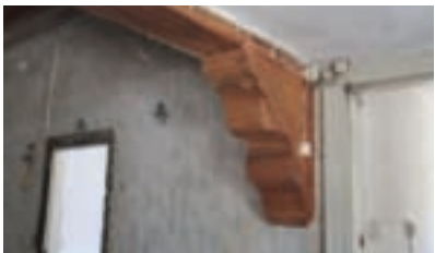
verzierte Knagge unter einem Holzriegel (Rähm) auf dem die Deckenbalken liegen als Kopfband zur Stütze n Wand.
